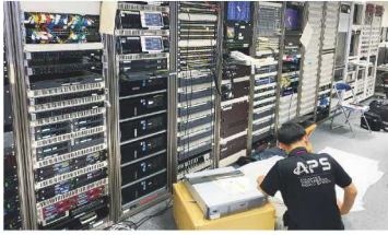
映像中継設備
