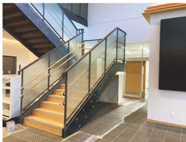
徳地地域複合型拠点施設に設置した ガラス製階段手すり
