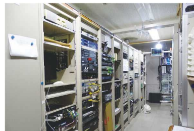
マスタールームの裏側に設けられたサーバールーム
